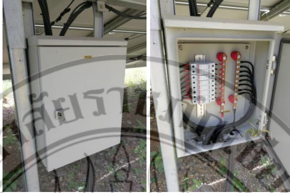
รูปภาพ 2.5 กล่องรวมสายไฟย่อยที่ติดตั้งใต้แผงเซลล์แสงอาทิตย์
